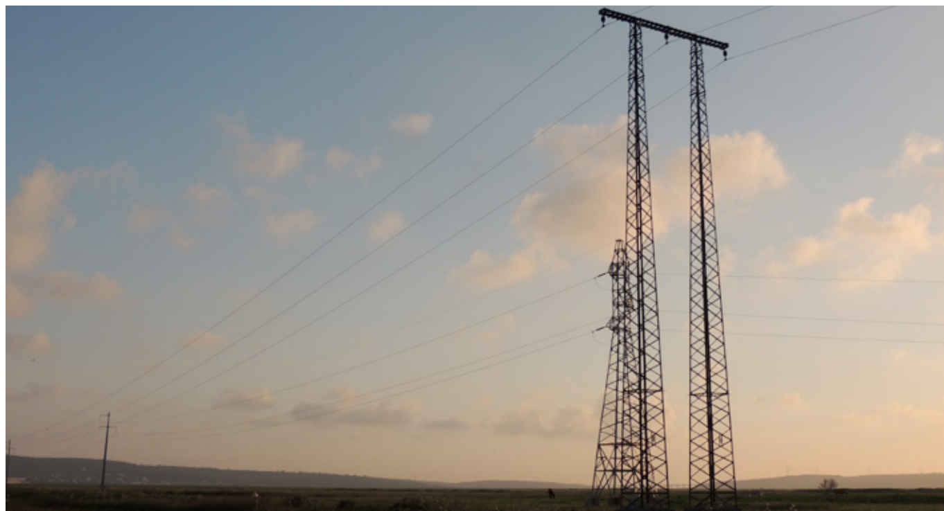
Ligne électrique traversant une plaine d'inondation à Kanouat, dans laquelle les grandes outardes étaient jadis présentes (photo © Tim Dodman).
