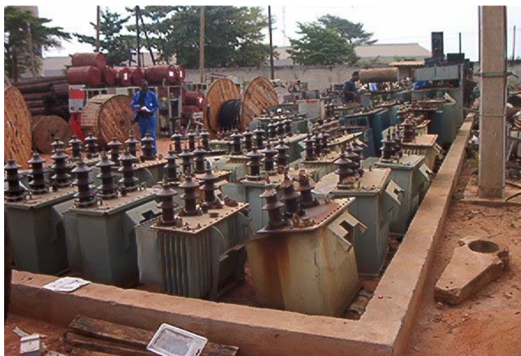
Figure 6 : Magasin non couvert d'équipements divers d'électricité.
