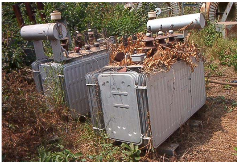
Figure 5 : Transformateurs à l'abandon.
