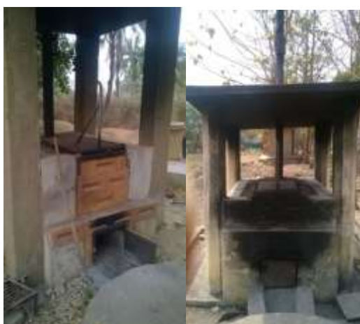
Photo 7 : Incinérateurs à grille de revêtement à Dassa
