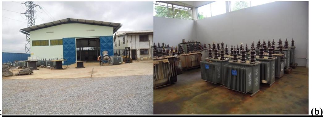
Figure 1: Magasin de stockage de transformateurs à PCB à Ngoussou (Yaoundé)
