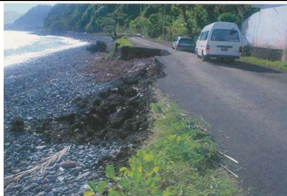
Figure 17 : Route endommagée par la remontée du niveau de la mer (Route de Pouzini – Anjouan)
