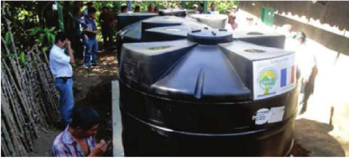
Fotografía 19. Captación y almacenamiento de agua lluvia.
