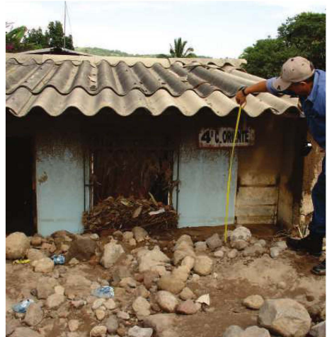
Fotografía 10. Impacto de deslizamiento en Verapaz por lluvia extrema, noviembre de 2009.
