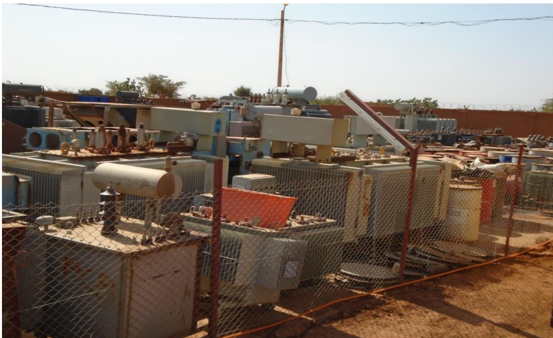
Photo 4: Plate-forme de stockage temporaire des transformateurs et déchets à PCB, Coordination Nationale du Projet PCB, 2016)
