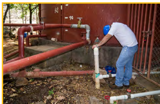
Foto 22: Tanque de almacenamiento de Empresa MACESA
