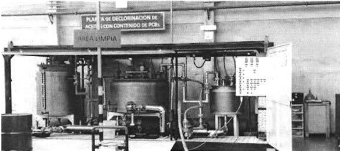
Figura N° 32: Declorinadora de la empresa TREDI S.A.
