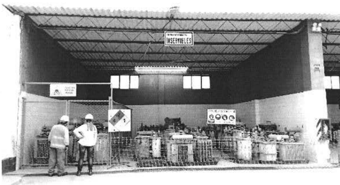
Figura N° 23: Área de almacenamiento de PCB dentro del almacén de residuos peligrosos
