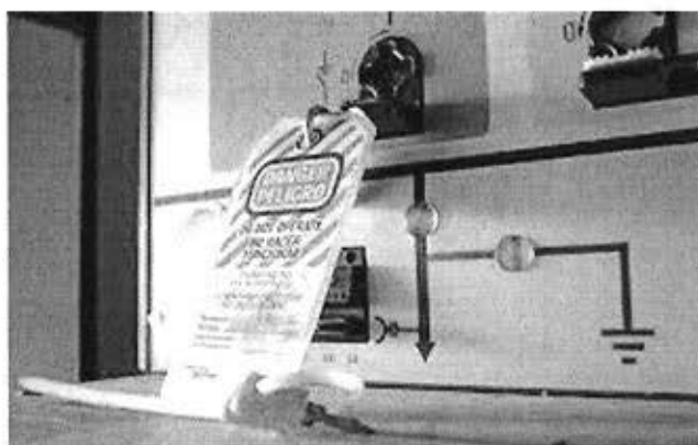
Figura N° 15: Bloqueo y etiquetado de un interruptor
