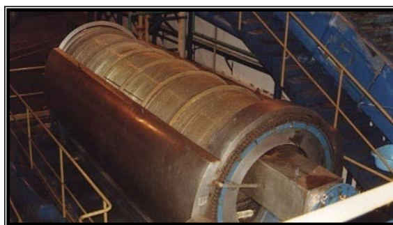
Filtro Rotativo con malla Jhonson de 1 mm.
