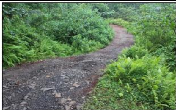
Troço da Estrada Nacional bastante danificado
