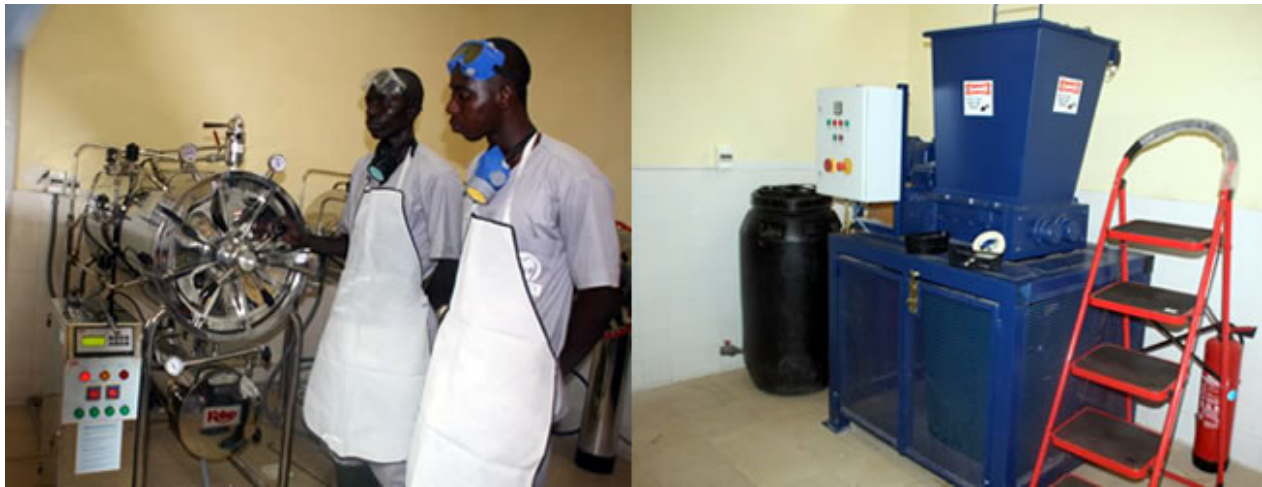
Un autoclave et un broyeur installé au centre de traitement des déchets biomédicaux de l'Hôpital de Grand Yoff
