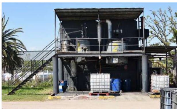
Ilustración 8: Torre de recuperación de solvente. Foto cortesía Márgenes del Río S.A.
