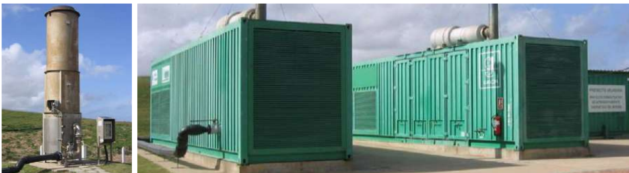
Ilustración 5: Generadores de electricidad a partir de biogás y antorcha en SDF Las Rosas
