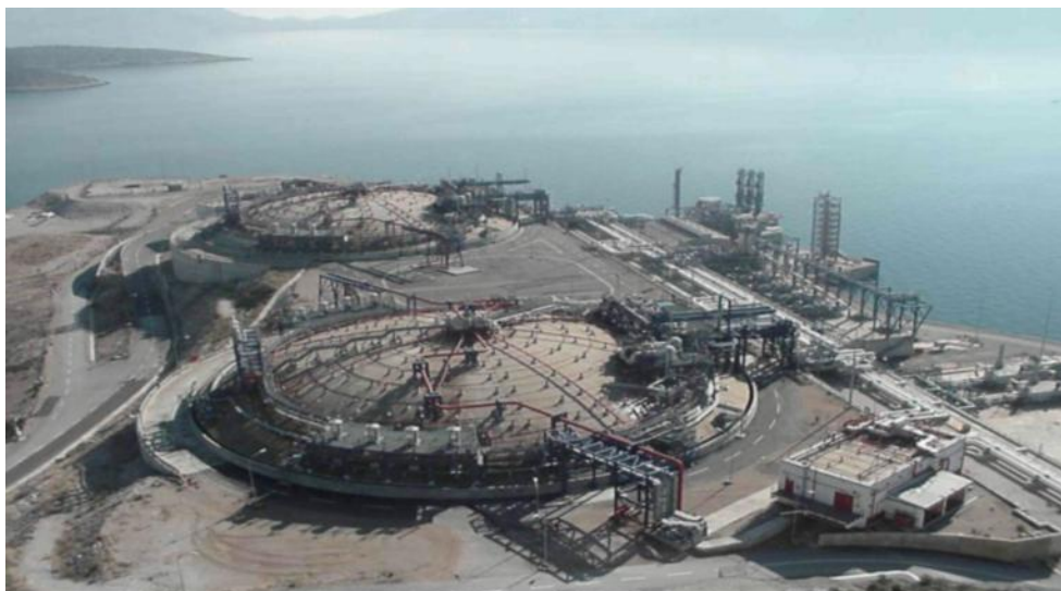
Figura 24 Terminali Revithoussa LNG
