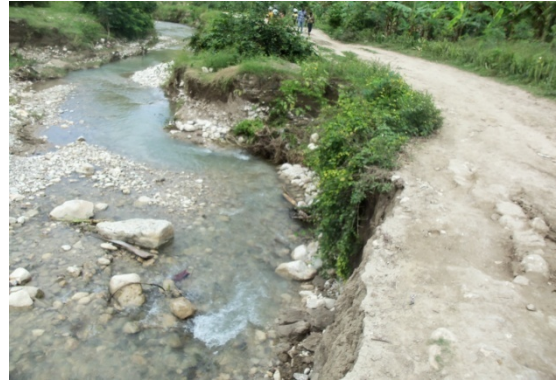
Eboulement de la route à Froison
