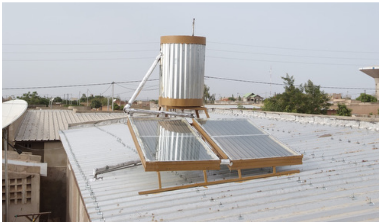
Chauffe-eau solaire classique de 200 litres sur un toit à Bobo-Dioulasso
