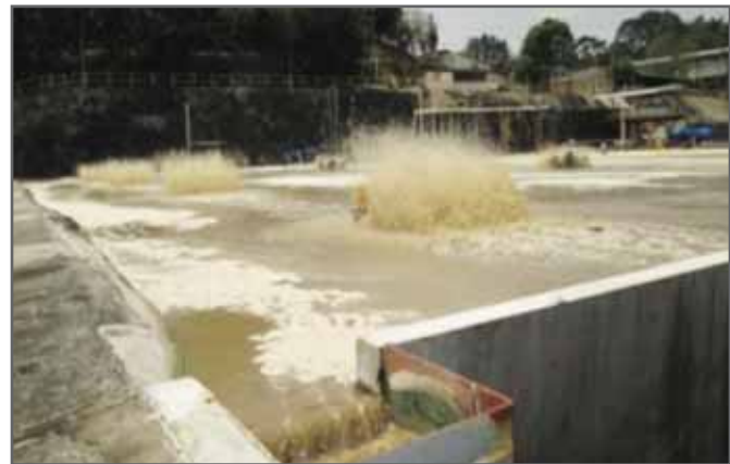
Aguas residuales de industria avícola vertidas con tratamiento al río Colón (Ciudad Arce)
