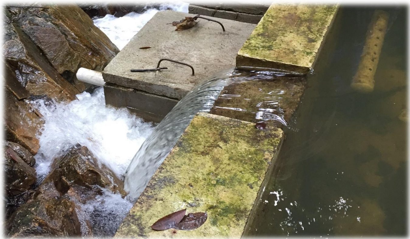
Fuente: MINSA, Vertedero en captación de acueducto rural de la comunidad de Corazón de Jesús, Guna Yala. Permite el paso del agua y la sostenibilidad de la vida acuática y actividades realizadas aguas abajo, 2016.
