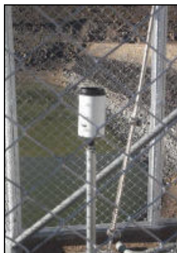
Fotografía N° 43 Estación Paucarani, Fluviógrafo automático tipo balancín
