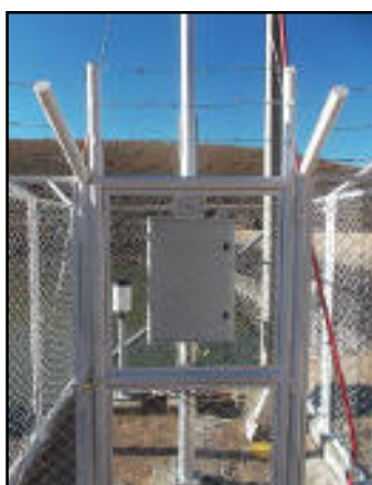
Fotografía N° 46 Estación Paucarani, Plataforma de Adquisición de Datos
