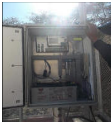
Fotografía N° 41 Estación Challata, Data Logger.
