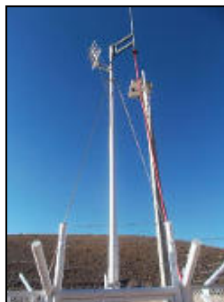
Fotografía N° 45 Estación Paucarani, Antena Yagui y panel solar
