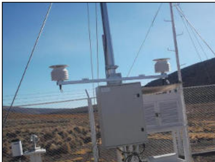
Fotografía N° 50 Estación Vilacota, sensor de humedad
