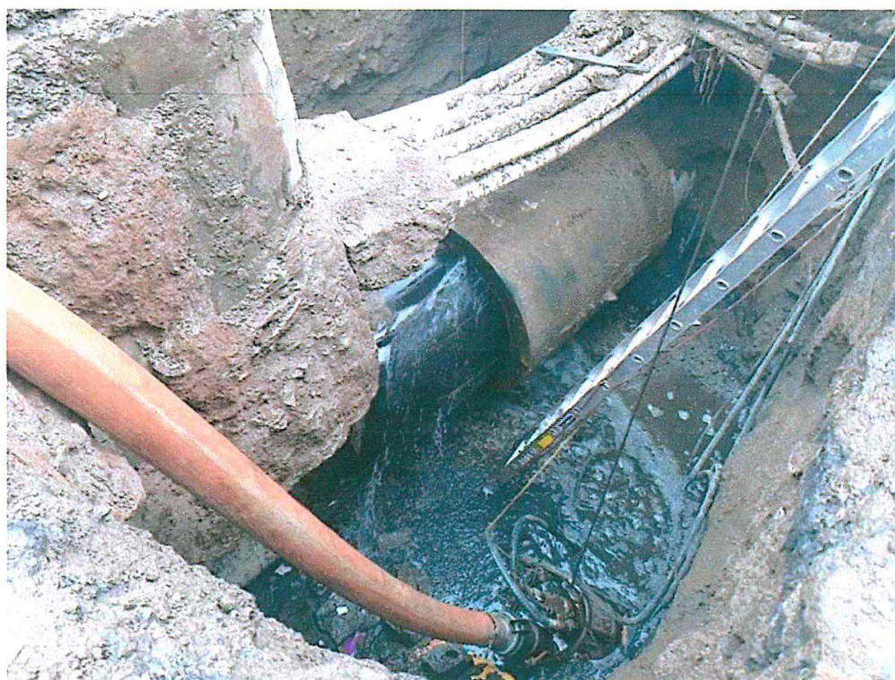
Foto 2: Daños a tuberías de agua en Iztapalapa tras terremoto. Fuente: Gobierno de la ciudad de México. 2017.
