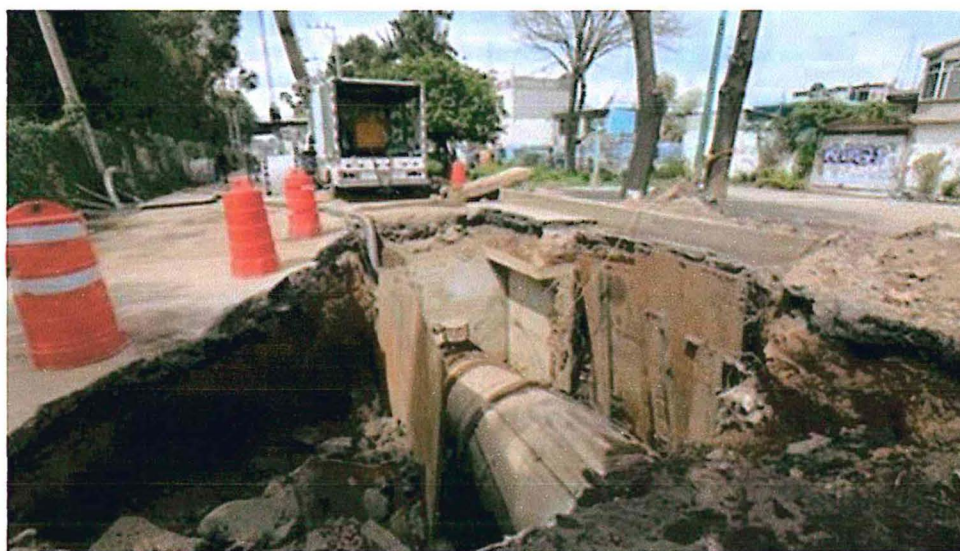
Foto 1: Daños a tuberías de agua en Iztapalapa tras terremoto. Fuente: Gobierno de la ciudad de México. 2017.
