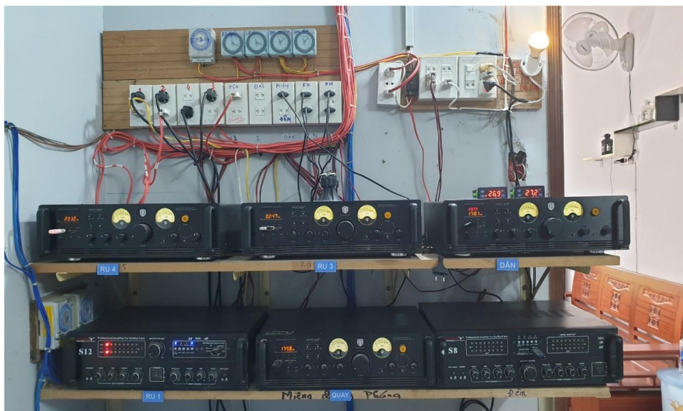
Hình 13. Thiết bị, máy móc trong phòng kỹ thuật (Nguồn: Võ Tấn Phong)
